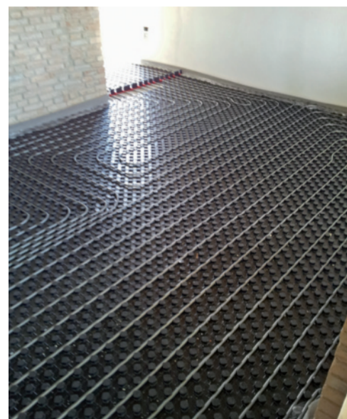
IL SISTEMA di riscaldamento a pavimento.
