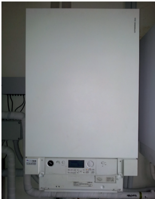
LA CALDAIA a condensazione Viessmann Vitodens 222 W 26 kW preesistente.
